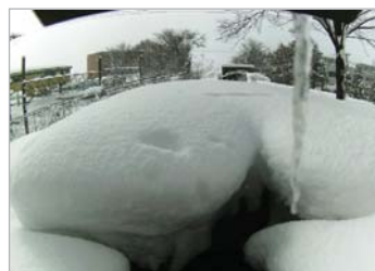
図 (a) 開水路上の雪庇
